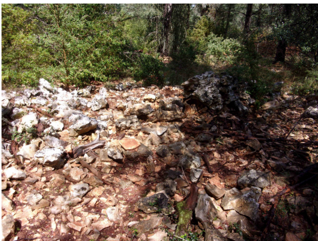
Ancien murêt effondré
