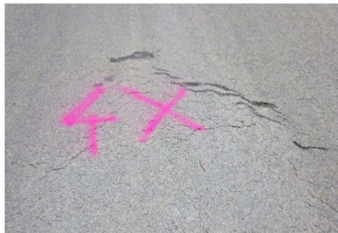
Figure 14 : défaut n°38 – fissures sur bande n°7 (profondeur 2 cm, source [4])
