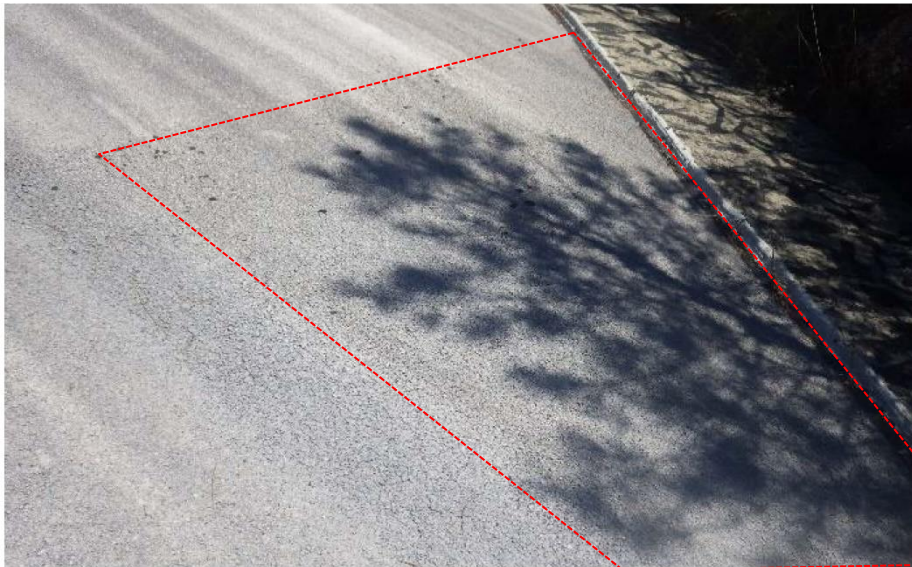
Figure 20 : Exemple de défaut de compactage identifiés en 2018
