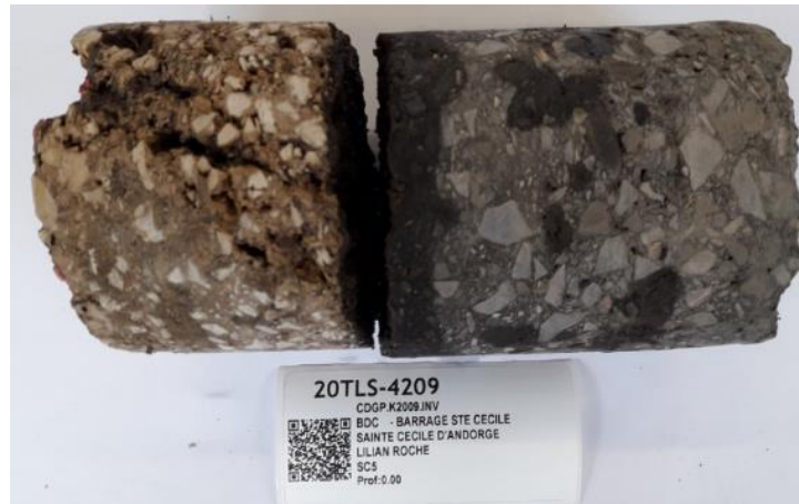
Figure 15 : Carotte SC5 prélevée au droit d'une zone de fissuration
