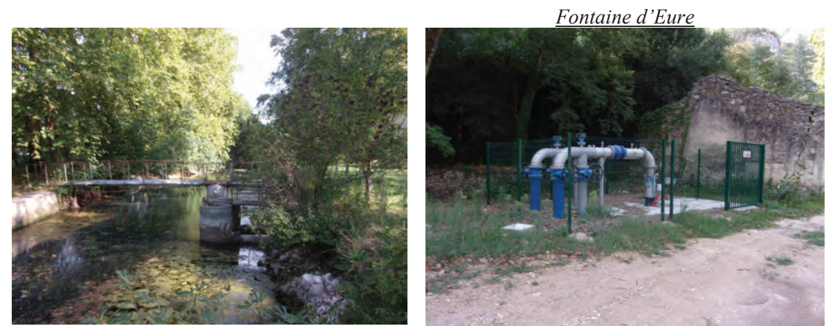
Ancien dispositif de pompage
