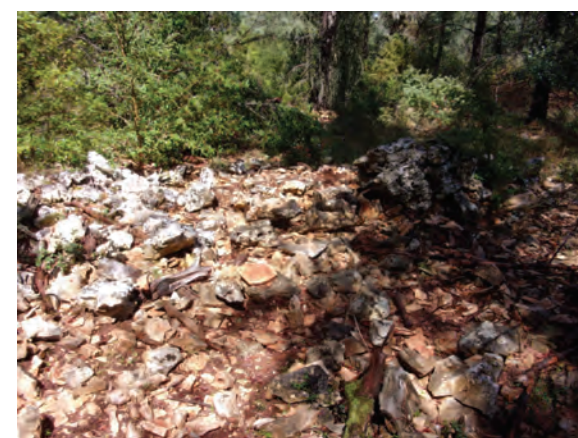
Ancien murêt effondré
