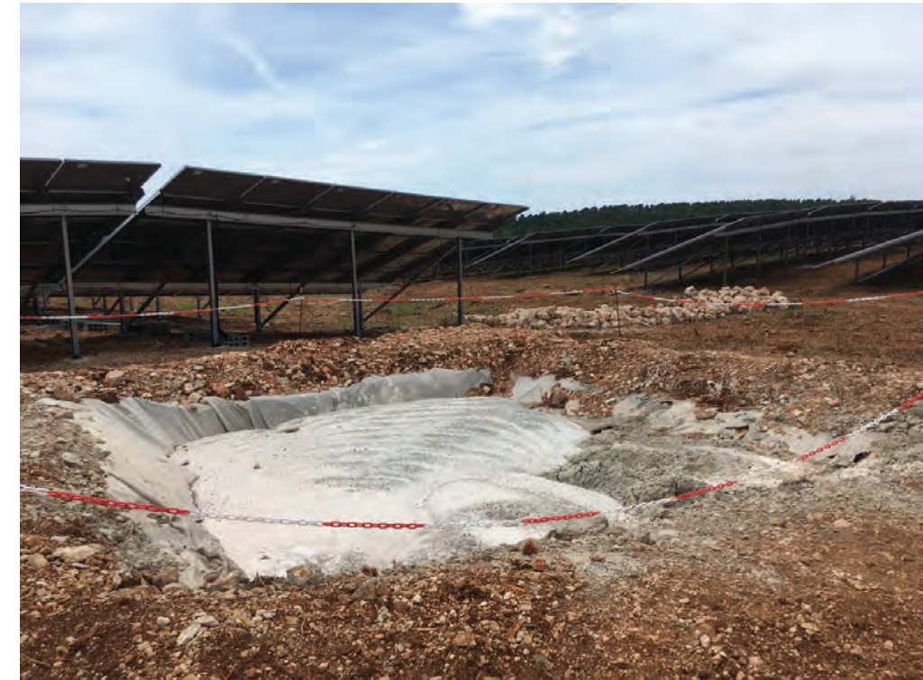
Fosse à béton mise en place sur le projet de centrale solaire de Moissac-Bellevue (83 – Var) (Source : Urbasolar)
