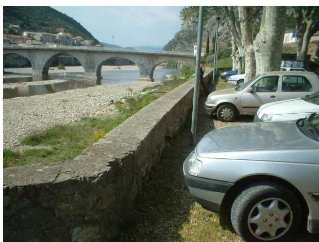
Parapet à rehausser
