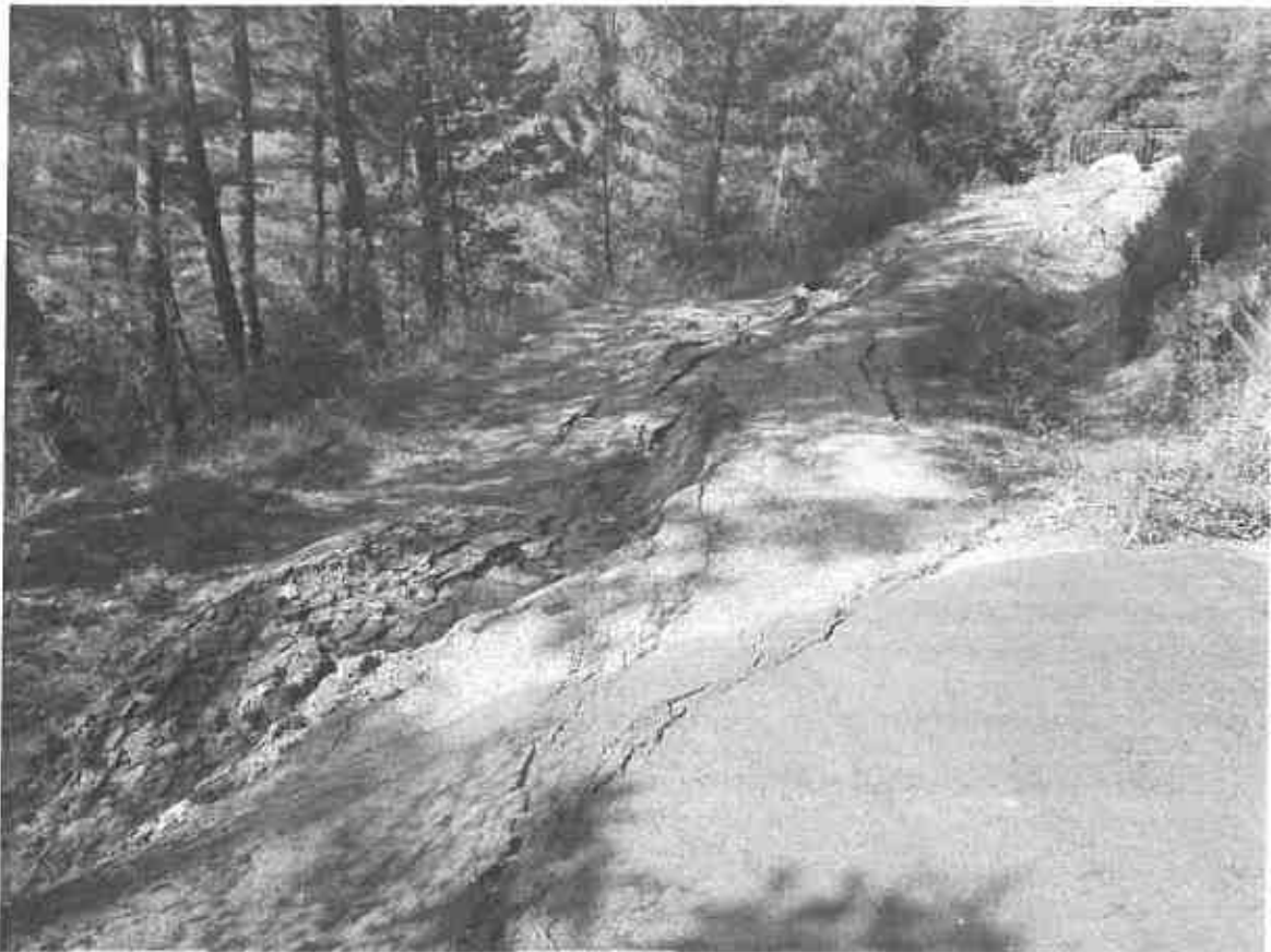
Figure 5 : Glissement de terrain en cours d'aggravation
