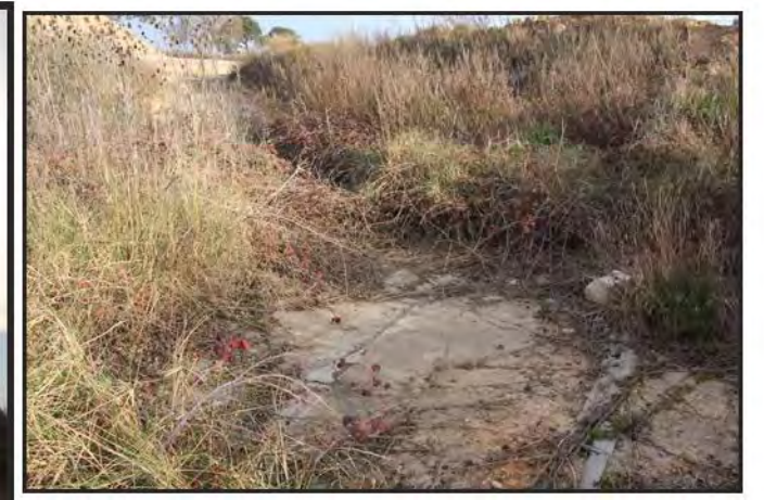
D - Ouvrage BRL situé au droit du premier niveau de la plateforme
