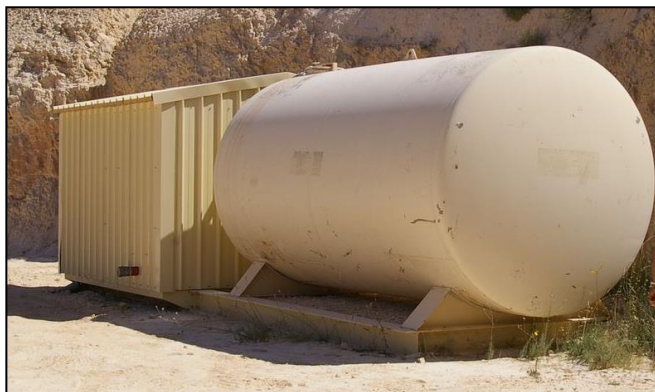
Cuve à eau équipée d'un raccord pompier sur le site de Pouzilhac
