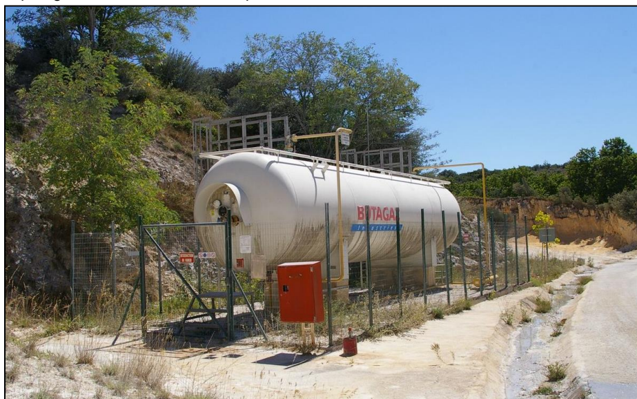
Photographie de la cuve GPL du site de Pouzilhac et des mesures de protection en place
