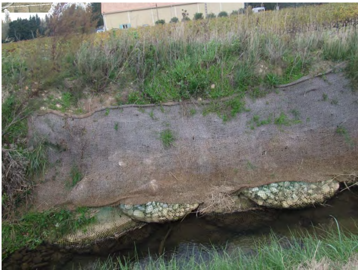
Figure B-4: Brèche sur Malaven (aval RD6580) colmatée avec des sacs de gabions
