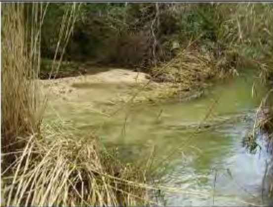
1 Brèche de 15m de large
