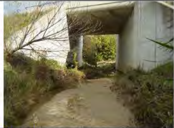
2 lit Malaven après rupture
