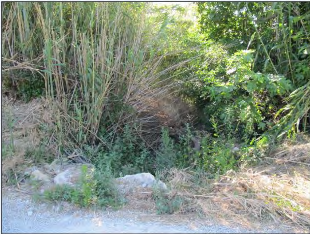
Figure B-5 : Brèche sur la digue des Fontaines (2011) suite à la rupture du Malaven non colmatée
