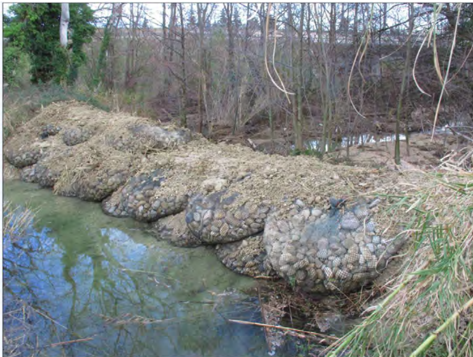
Figure B-3 : Brèche sur Malaven (amont LGV) colmatée avec des sacs de gabions
