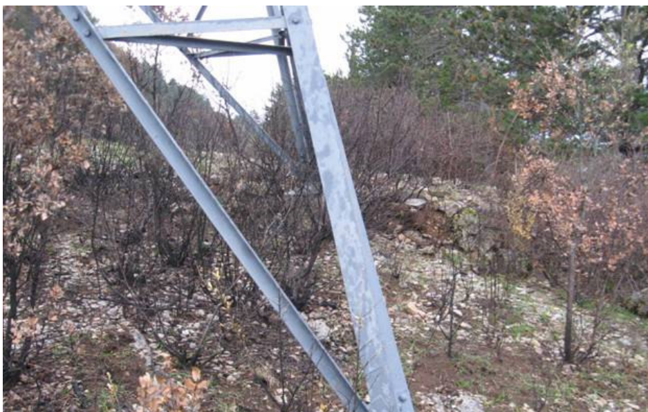
Figure 8 : Ce feu pourrait être dû à un amorçage entre le pylône et la végétation proche
