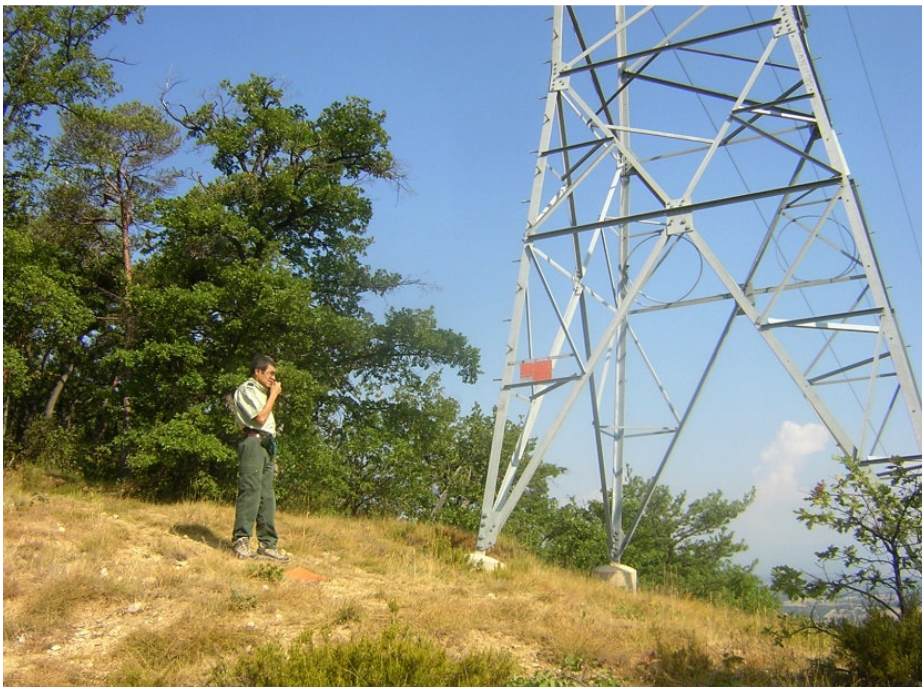
Figure 10 : Autour de ce pylône il reste encore des herbacées susceptibles d'amorcer, mais leur couvert est faible
