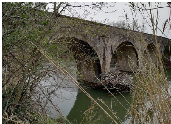
Embacles sur le pont de la Cèze - RD 765
