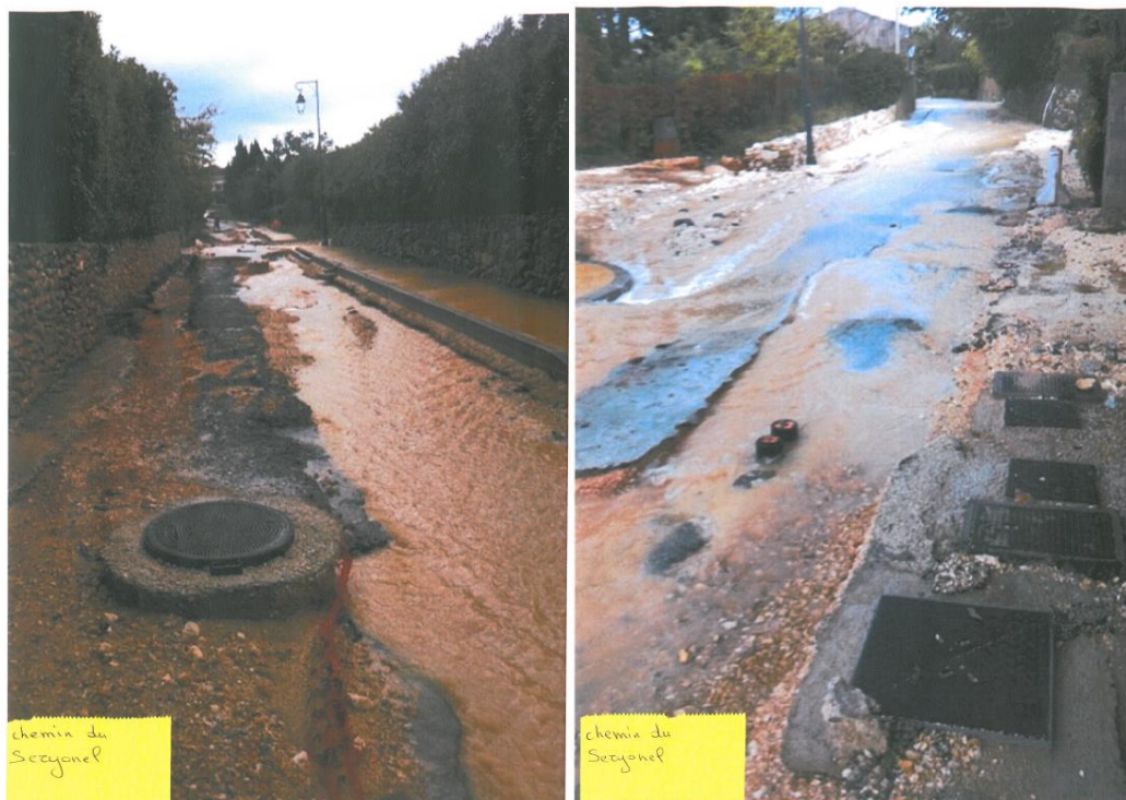
Exemple de dégâts sur la voirie au niveau de Flaux
