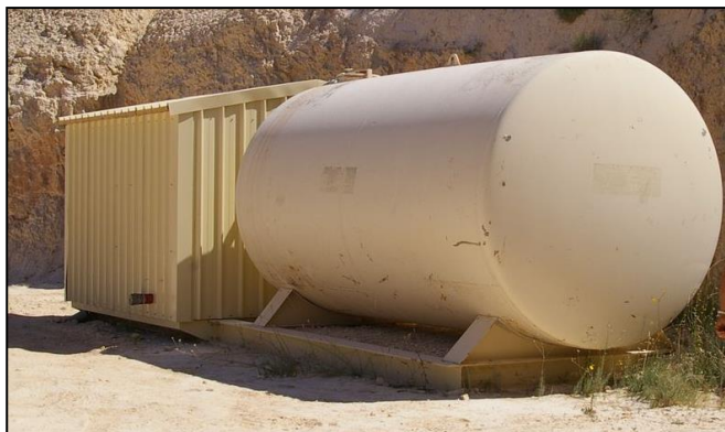
Cuve à eau équipée d'un raccord pompier sur le site de Pouzilhac
