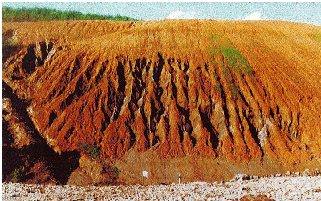
état de la digue à stériles de la Croix de Pallières après les orages de 1996 (Dossier UM-BUGECO 1998, p. 32, CDP-001)
