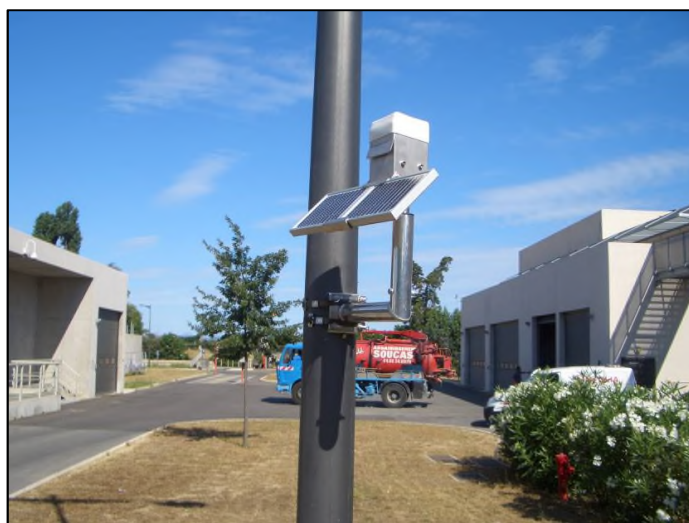
Figure 68 - Exemple de capteur H 2 S et de son alimentation solaire
